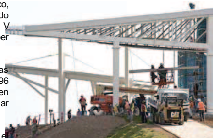
Obreros e ingenieros trabajar arduo en la instalación del atrio en Silao, Guanajuato, donde el pontífice oficiará otra misa, donde esperan unas 300. MI personas.
